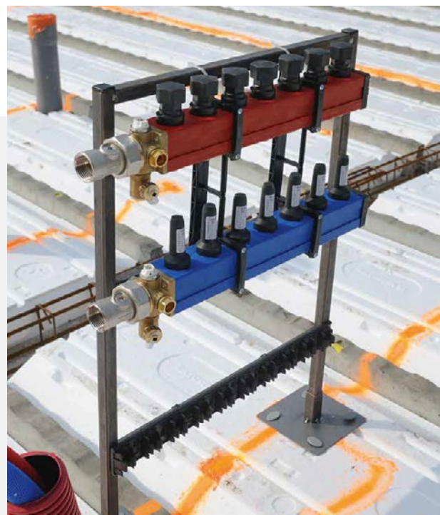
■ Fixation des collecteurs sur les 2 traverses hautes à l'aide de colliers de serrage.
