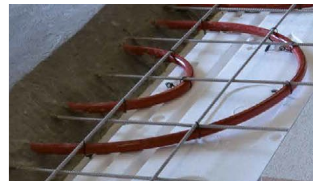
■ Le treillis et les tubes sont directement intégrés dans la dalle de compression.
